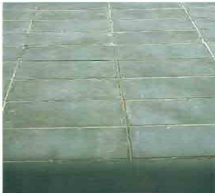
fot. 47 veduta della nuova pavimentazione interna della galleria in sasso tipo Moltrasio.
