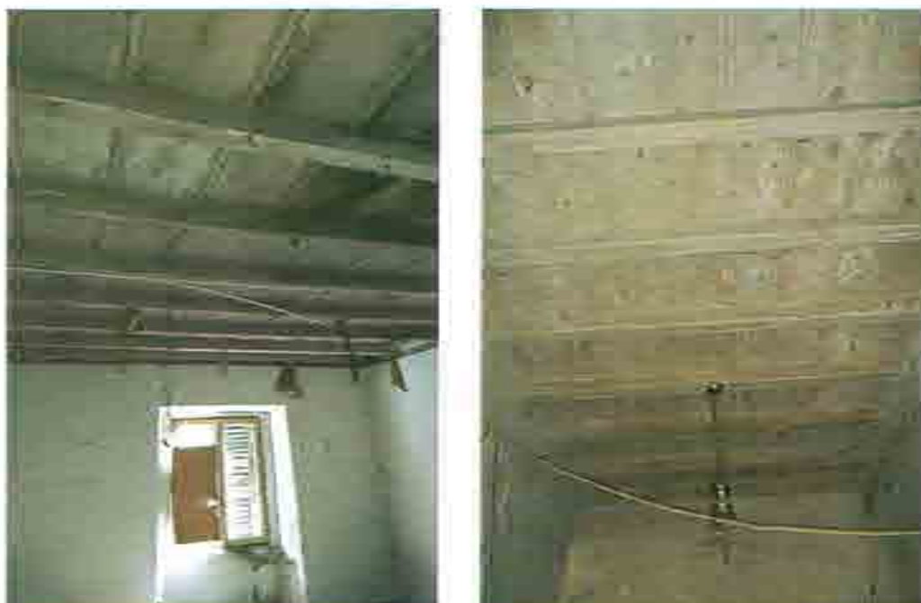
fot. 60 - 61 veduta di alcuni soffitti lignei della costruzione. Generalmente tutti i soffitti presentano fenomeni di sfogliamento delle pellicole pittoriche originarie dovute ad incauti interventi di epoca più recente..
