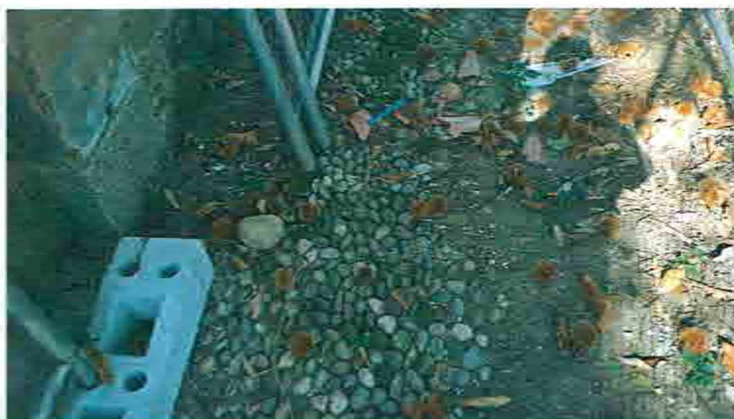
fol. 21 veduta di un tratto tipo del marciapiede perimetrale in acciottolato, assai compromesso e di cui si prevede la rimozione e ricostruzione mediante il riutilizzo dei ciotoli esistenti.
