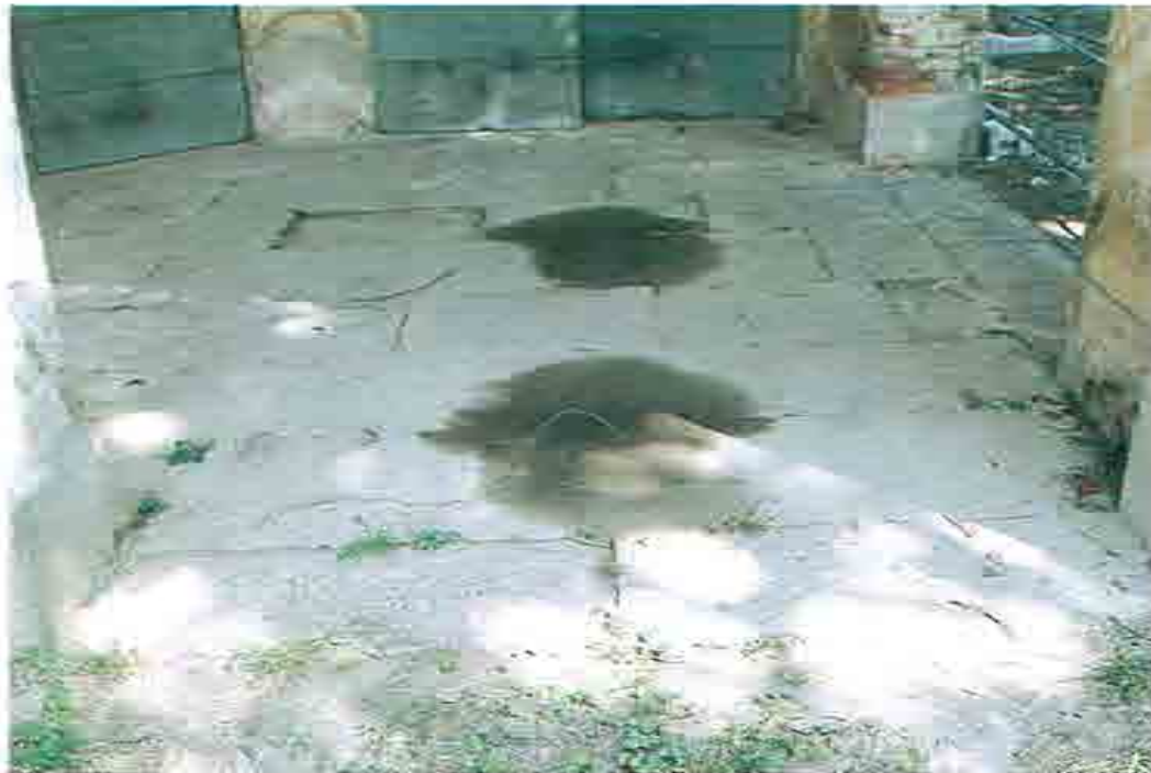
fol. 22 veduta di un tratto tipo della pavimentazione del portico in lastre sagomate in sasso "tipo Moltrasio" che il progetto prevede la sola messa in quota delle pietre sconnesse a causa del cedimento del sottofondo al fine di ridare complanarità alla stessa.
