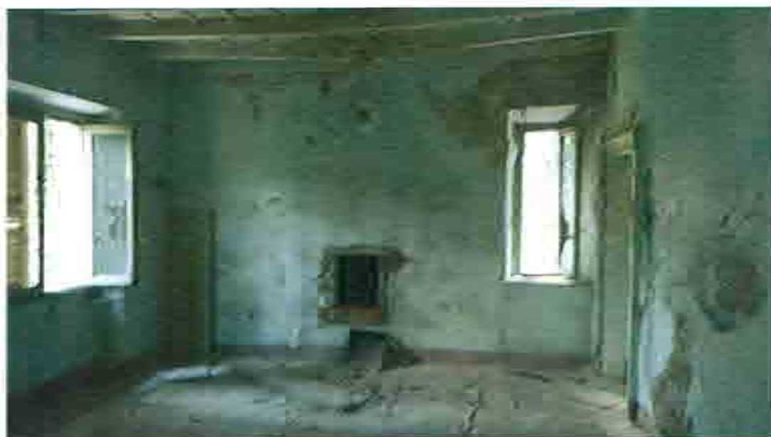
fot. 43 veduta interna dei locali di abitazione al piano primo (in condizioni statiche precarie) - il pavimento è composto da un foglio in p.v.c. sottostante il quale - forse - si conservano pianelle in cotto
