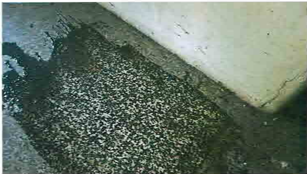
fol. 42 veduta interna della pavimentazione dei locali di abitazione al piano primo (verso nord) in marmette di graniglia di marmo bianco e verde.
